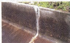
老朽化した目地部
