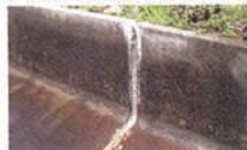
老朽化した目地部
