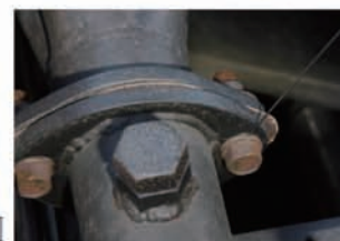
錆び付いて固着したボルトナットに
