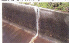
老朽化した目地部
